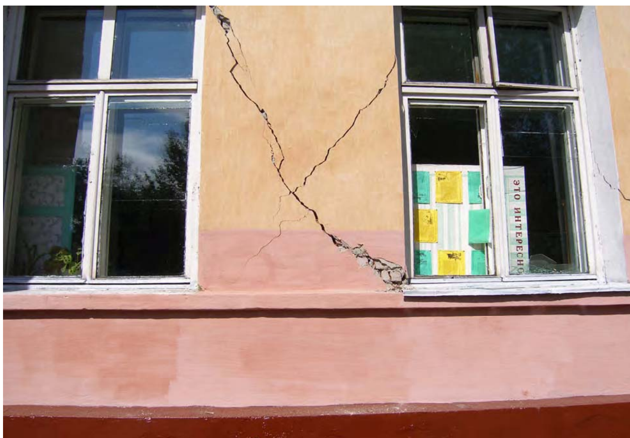
Рис. 1.2.2.1. . Трещины в стене здания школы в поселке Култук после землетрясения 2 августа 2008 года
